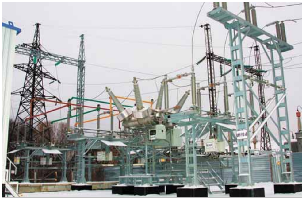
Увеличение мощности подстанции «Кузнечевская» позволит устранить энергодефицит в северной части Архангельска, где постоянно растет потребление электроэнергии.
